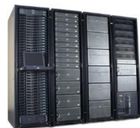
Figure 7: Baie de serveurs
